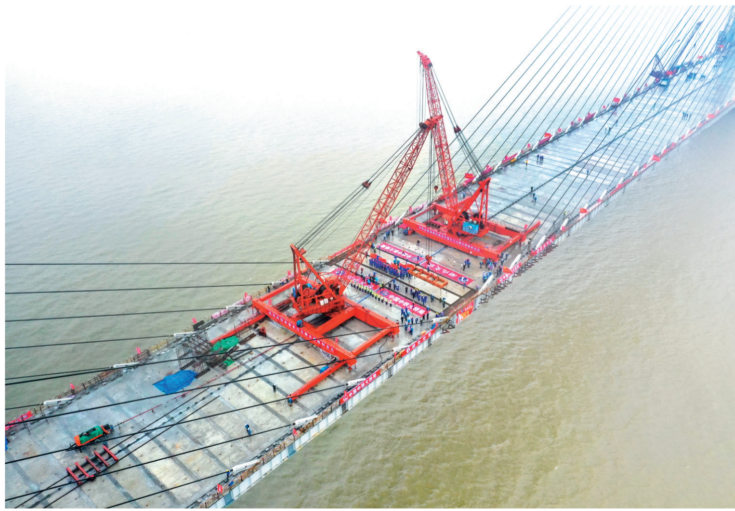
3月16日拍摄的洪湖赤壁长江公路大桥合龙现场。当日,由湖北交投集团投资建设、中铁大桥院设计、中铁大桥局施工的湖北赤壁长江公路大桥顺利合龙。据介绍,赤壁长江公路大桥起于湖北省洪湖市乌林镇水府村,止于赤壁市赤壁镇普安村,主桥长1380米,全线采用双向六车道一级公路标准建设,设计时速100公里,采用主跨720米的钢混结合梁斜拉桥方案。
