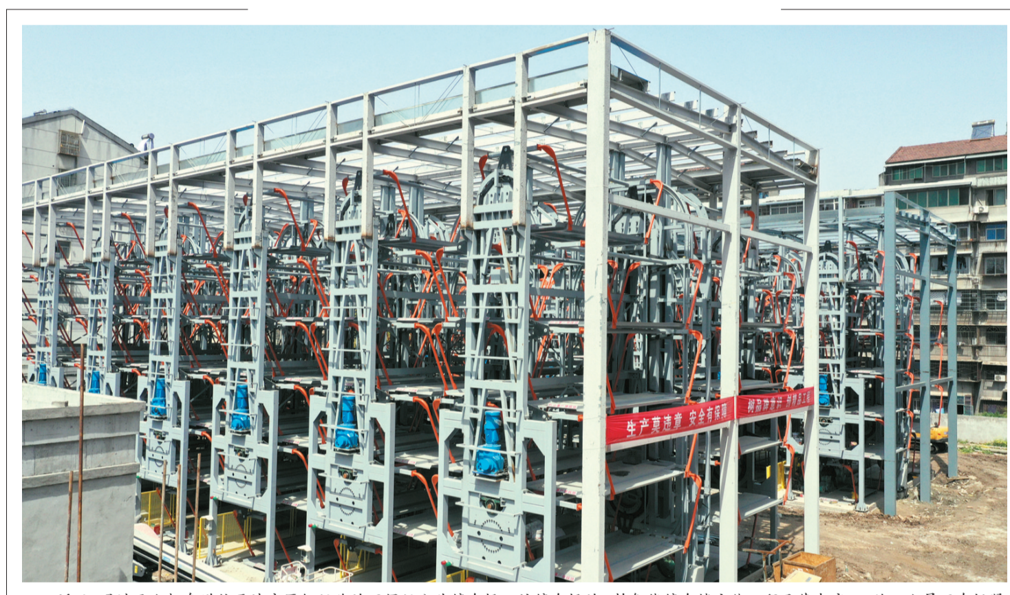
近日,通过无人机俯瞰位于沙市区红门路的石闸门公共停车场。该停车场的2栋智能停车楼主体工程已基本完工,施工人员正在抓紧安装内部设施,预计4月全面建成。该项目属垂直循环立体车库,计划提供停车位283个,以缓解红门路周边停车难等问题。(记者 梅闻 潘路 摄)
