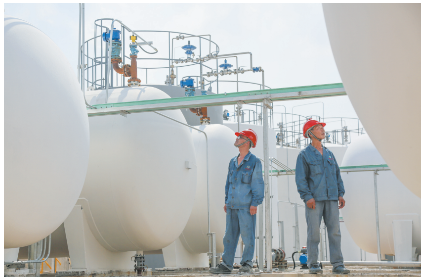
7月22日,工作人员在汇达科技新厂区检查设备。(记者 张梦瑶 摄)
