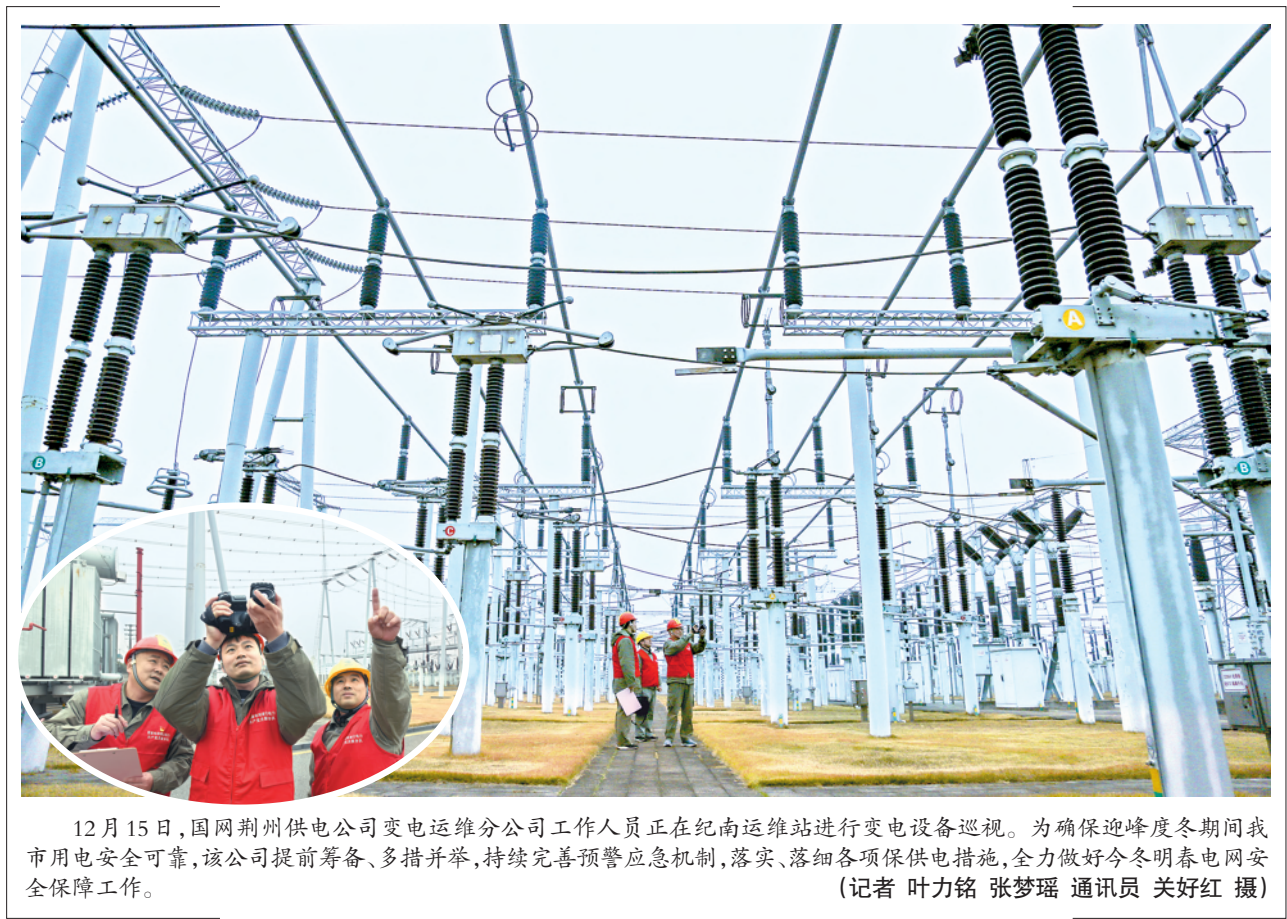
12月15日,国网荆州供电公司变电运维分公司工作人员正在纪南运维站进行变电设备巡视。为确保迎峰度冬期间我市用电安全可靠,该公司提前筹备、多措并举,持续完善预警应急机制,落实、落细各项保供电措施,全力做好今冬明春电网安全保障工作。(记者 叶力铭 张梦瑶 通讯员 关好红 摄)
