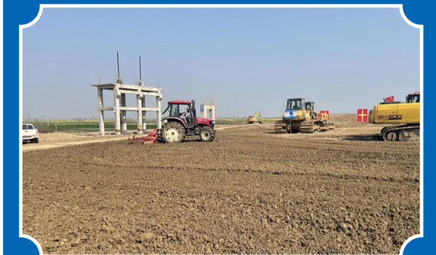
腰口隔堤身填固作业现场,40辆运土车驶进驶出,建设场面火热。
