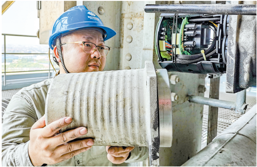
国能长源荆州热电有限公司生产厂区,工人仔细检查设备。(通讯员 刘珍 摄)
