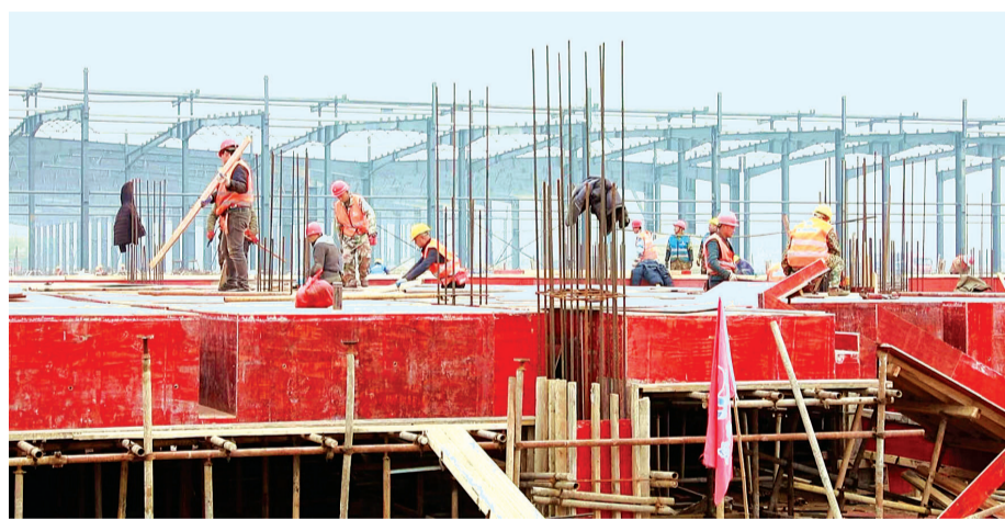
近日,洪湖安并预制菜生产建设项目现场一派繁忙景象,整体项目正按照施工计划加快推进。该项目总投资10亿元,主要生产淡水鱼、调味小龙虾、肉制品、水生蔬菜四大系列预制菜肴,预计今年年底投产。(记者 唐蜜 摄)
