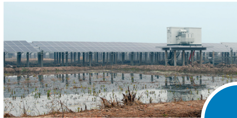
投资4亿元的70兆瓦渔光互补光伏发电项目顺利投产。
