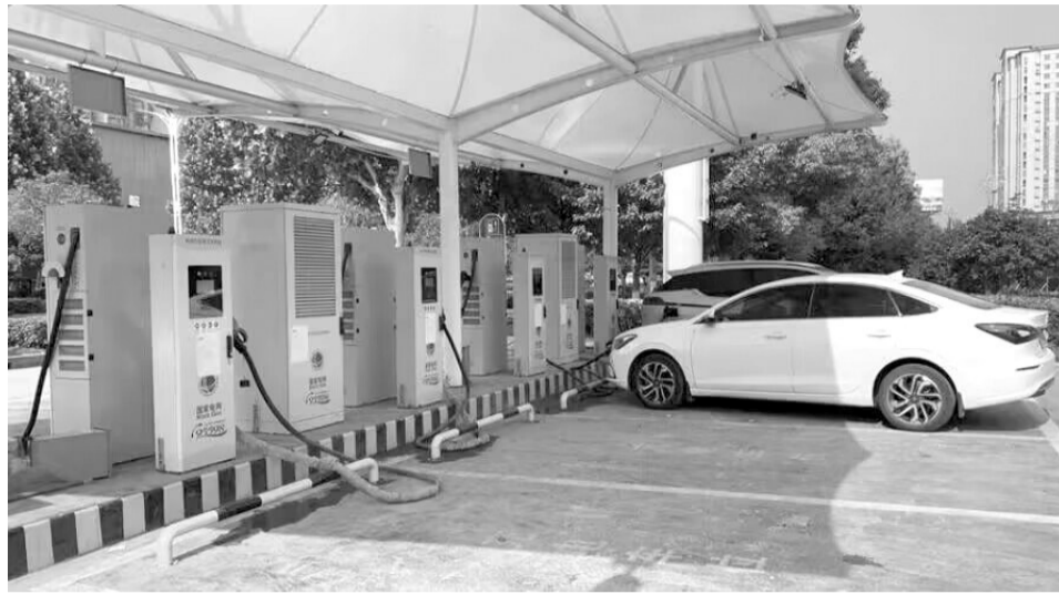
住宅小区充电桩。
