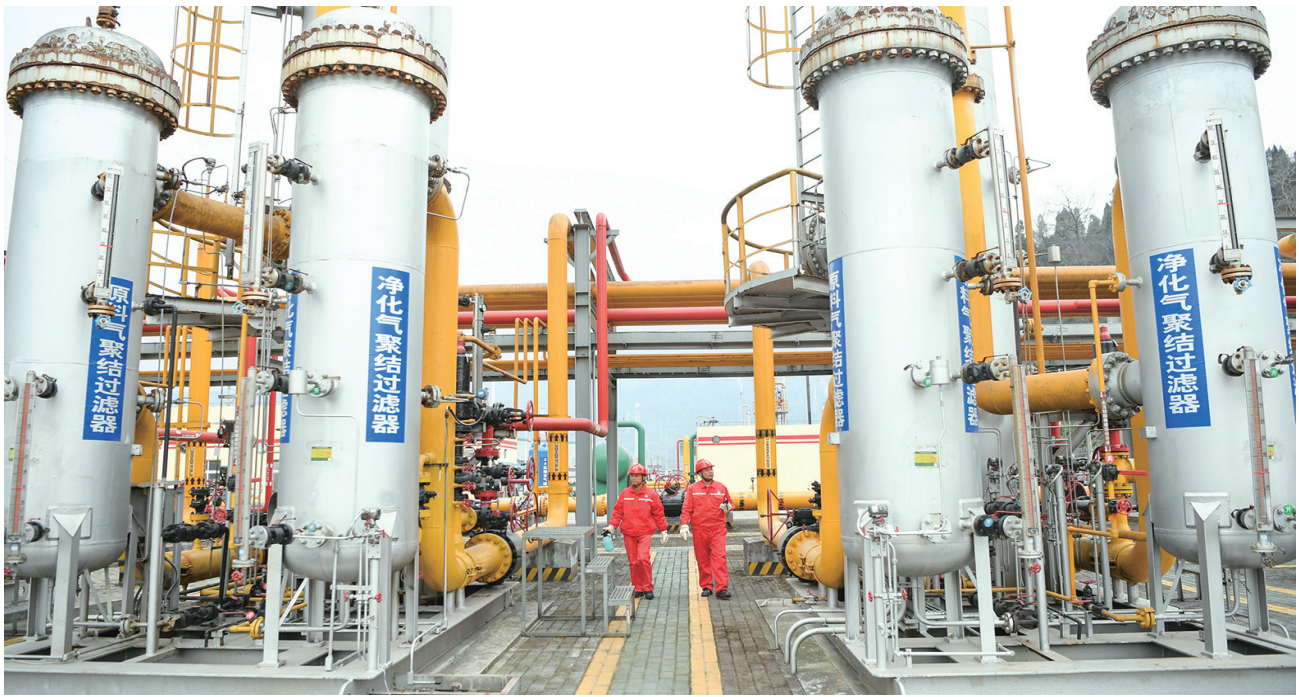
2月29日,技术人员在重庆涪陵页岩气田白涛集输站对设备进行巡检。中国石化江汉油田涪陵页岩气公司自主研发网电钻机、全电压裂机组等装备工具,关键设备全部实现国产化,并着力用创新力量提高储量动用率和采收率。(新华社 发)
