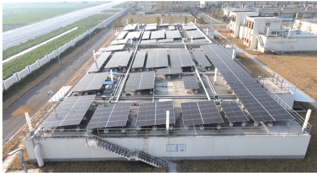
观南路污水处理厂内连片的光伏板源源不断将光能转化为清洁电力,为厂区生产运行注入绿色动能。
