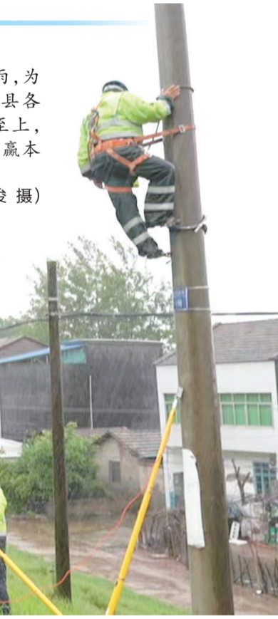
国网公安供电公司组织精干力量,全力抢修因暴雨导致的电力故障,保障附近泵站稳定供电排水。
