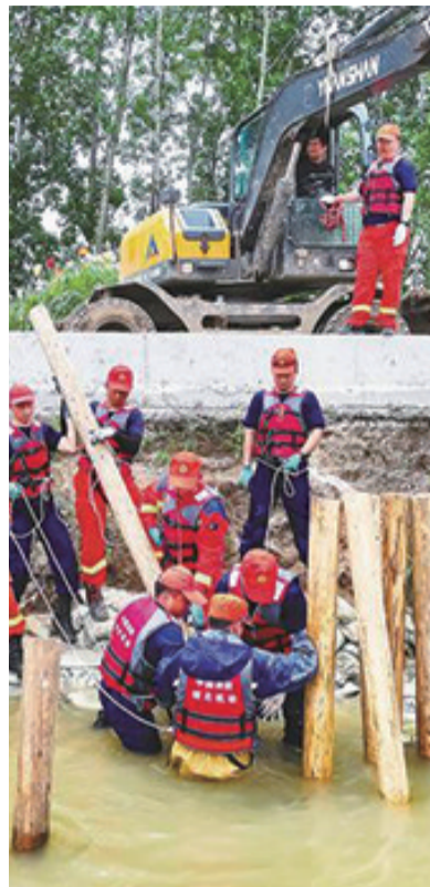
消防员对堤坝迎水坡和堤脚进行加固。(湖北日报通讯员 牛振仓 摄)
