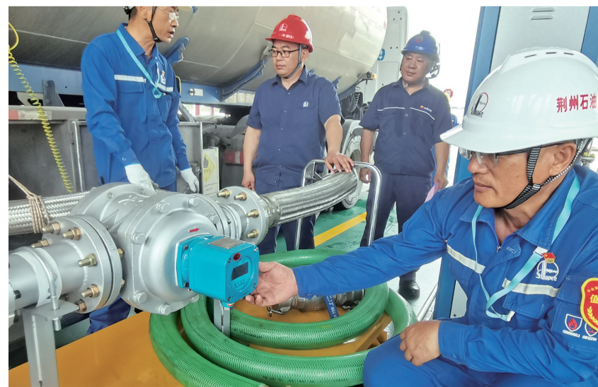
近日,中石化荆州公司荆州油库推出一项实用小发明——流量计撬装在线自校移动式小车,该发明可有效破解传统公路流量计自校作业环节繁琐、效率低下,且存在安全环保隐患的痛点。(记者 潘路 通讯员 刘琦 摄)
