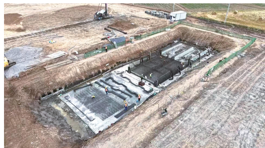
近日,公安经济开发区铁路专用线及配套工程施工正酣。该工程总投资超17亿元,是湖北省重点交通项目、国家发展改革委重点推进的铁路专用线项目,目前已进入水泥搅拌桩复合地基施工关键阶段。项目竣工后,远期年货运量预计达1235万吨,既能破解企业运输“最后一公里”难题,降低物流成本,更将重塑区域能源运输格局——未来西北煤炭可经此直达公安港区,中转至华中、华东地区。(通讯员 赵勇 彭荣利 张再泽 撰)
